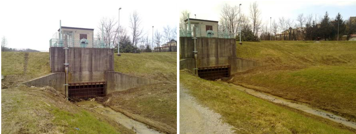
Figura 4 – Bacino de Pikolud sul torrente Corno in territorio Sloveno: organi di regolazione
