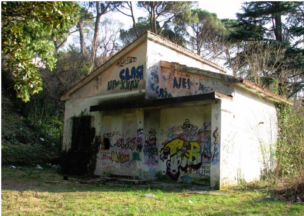
Figura 31: stato di fatto dell'edificio da ristrutturare come punto informativo di ingresso e accoglienza al parco.
