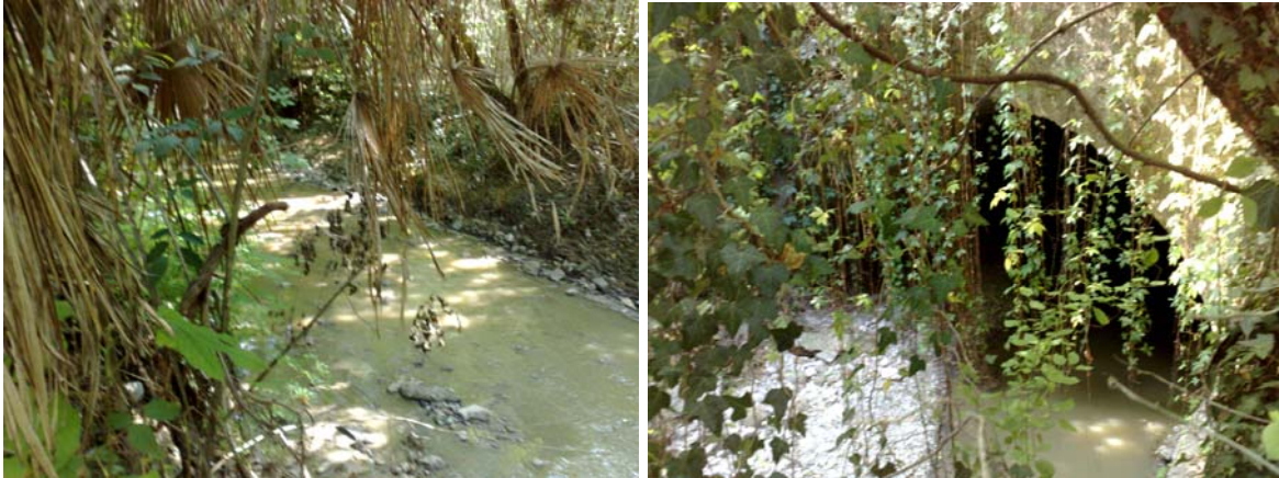
Figura 7 – Il tratto di Corno a fondo naturale nell’area della Valletta e l’ingresso del tratto tombato al disotto di via Cristoforo Colombo. E’ evidente l’alto grado di inquinamento delle acque che attualmente defluiscono nel torrente.
