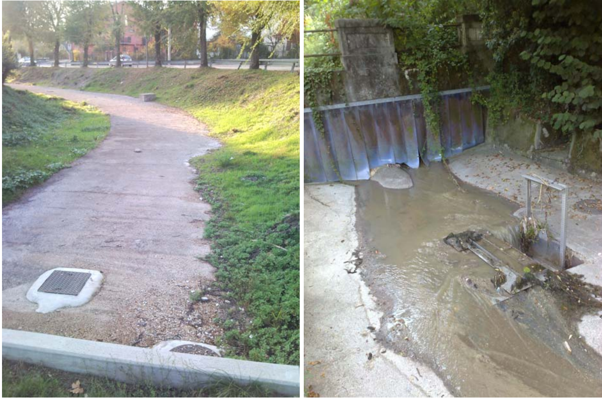
Figura 5 Il Corno nel tratto intubato di via dei Catterini a Gorizia (immediatamente a valle del confine di stato) ed, a destra, l'uscita nell'area della Valletta. E' visibile l'imbocco della tubazione posata dalla Protezione Civile nel 2009 e la paratoia di collegamento tra la stessa e la fognatura di Gorizia. E' evidente l'incapacità della stessa a raccogliere tutti i liquami che interessano l'alveo del Corno.
